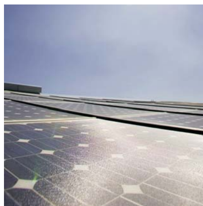
CIM la Selva, instal·lació fotovoltaïca
