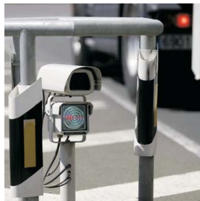
Control de acceso de vehículos
