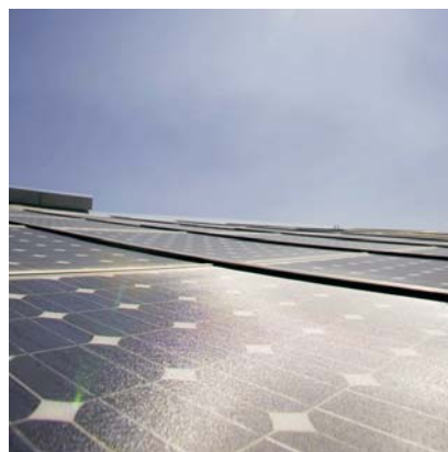
CIM la Selva, instalación fotovoltaica
