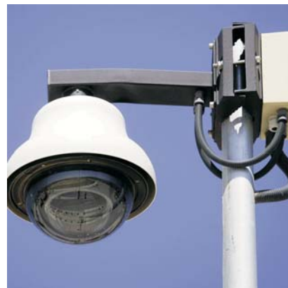
CIM la Selva, seguridad y vigilancia
